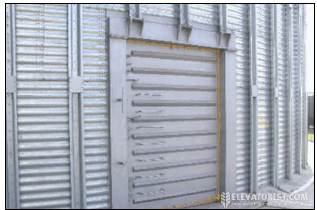
Рис. 11. Розташування входних люків з порушенням відстаней між болтовими отворами
