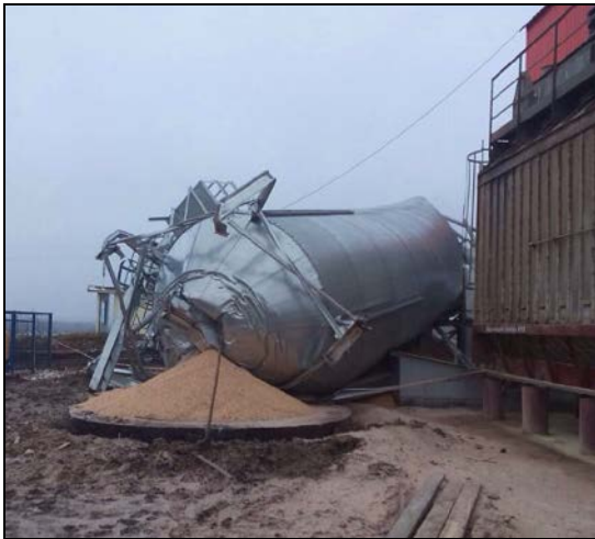
Рис. 8. Падіння силосної споруди внаслідок втрати стійкості опорними елементами
