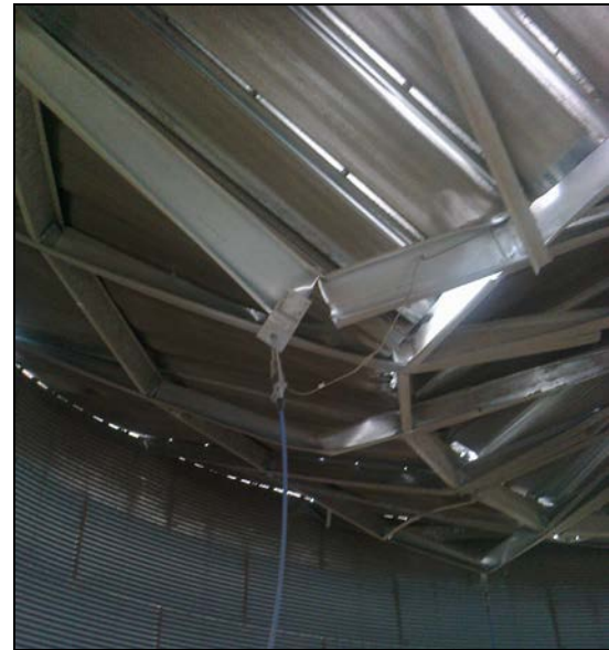
Рис. 9. Руйнування криши силосної споруди внаслідок втомних деформацій
