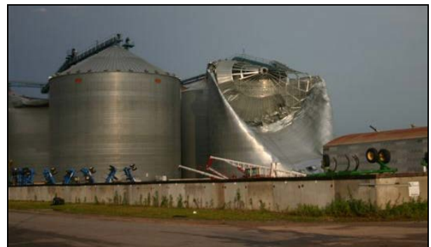
Рис. 7. Деформація корпусу силосу внаслідок перекосу фундаменту
