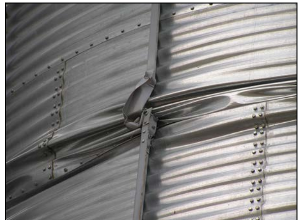
Рис. 16. Втрата місцевої стійкості стінки в місці зміни перерізу підкріплюючих стійок
