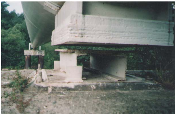
Рис. 11. Утворення зазору між опорною поверхнею металеві площини і ложементом проміжної опори на надземному переході МГ «Уренгой-Помари-Ужгород», Ду 1400 через р. Латориця
