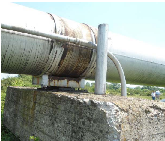
Рис. 3. Руйнування ростверку залізобетонної опори надземного переходу МГ «Івацевичі-Долина» II нитка, Ду 1200 через р. Свіча
