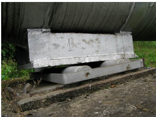
Рис. 14. Технічний стан рухомої опори надземного переходу МГ «Комарно-Держжордон» Ду700 через р. Вишенька
