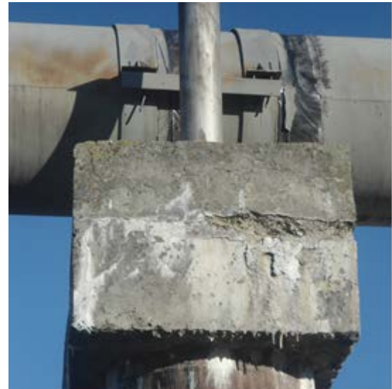
Рис. 4. Руйнування ростверку залізобетонної опори надземного переходу МГ «Івацевичі-Долина» II нитка, Ду 1200 через р. Свіча
