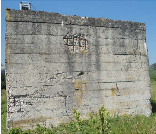
Рис. 5. Руйнування залізобетонної ділянки анкерної опори для розтяжок пілонів вантового переходу МГ «Івацевичі-Долина» II нитка, Ду 1200 через р. Дністер
