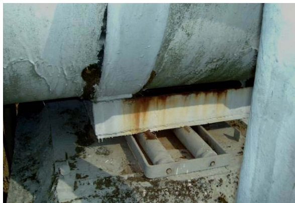
Рис. 9. Зміщення рухомої опори від проектного положення на надземному переході через р. Дністер МГ «Івацевичі-Долина» – 3 нитка, Ду 1200 у перпендикулярному напрямку до осі трубопроводу
