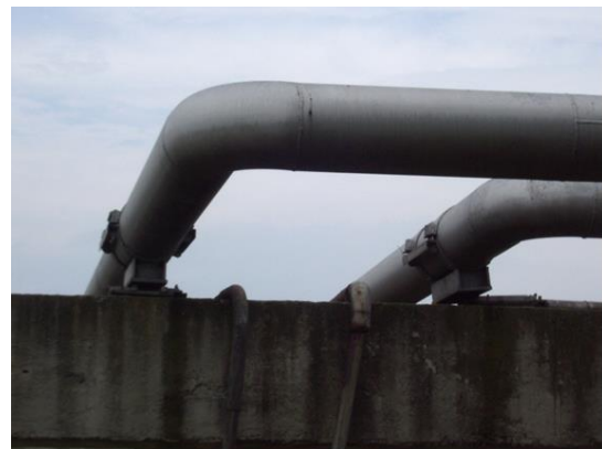
Рис. 12. Зміщення рухомої опори на Г-подібному компенсаторі надземного переходу МГ Пукеничі-Дашава Ду500 через р. Стрий
