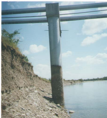
Рис. 6. Вимивання ґрунту навколо буронабивної залізобетонної палі у береговій зоні надземного переходу МГ Пукеничі-Дашава Ду500 та МГ Пукеничі-Долина Ду 700 через р. Стрий
