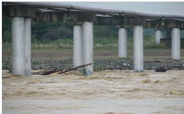
Рис. 10. Прямолінійна частина багатопрогонового надземного переходу через річку, який зазнає впливу поздовжньо-поперечного згину
