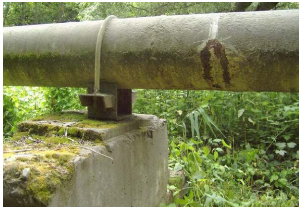
Рис. 2. Технічний стан опори № 5 газопроводу середнього тиску від ГРС «Розвадів» до ПАТ «Миколаївцемент» – II нитка
