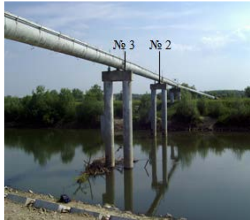
Рис. 7. Розмивання ґрунту навколо буронабивних залізобетонних палей, які встановлені у зоні русла ріки на надземному переході МГ «Івацевичі-Долина» – 3 нитка, Ду 1200 через р. Дністер
