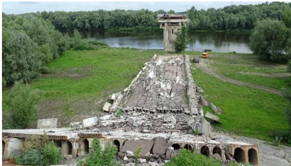
Рис. 5. Зруйнований автомобільний міст через р. Десна біля с. Велике Устя Чернігівської області
