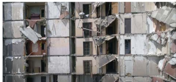
Рис. 1. Зруйнований житловий фонд
