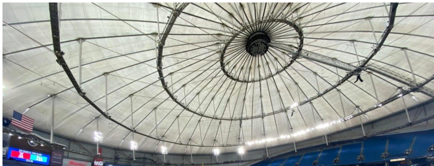
Рис. 3. Стадіон Тропікана – кожне внутрішнє кільце з'єднано із зовнішнім канатними елементами
