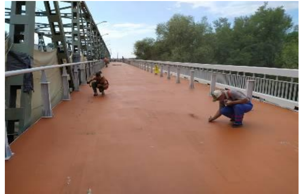
Рис. 1. Аварійно-відновлювальні роботи на мості на автомобільній дорозі М-06 Київ-Чоп км 831+711 через р. Тису, Закарпатська область
