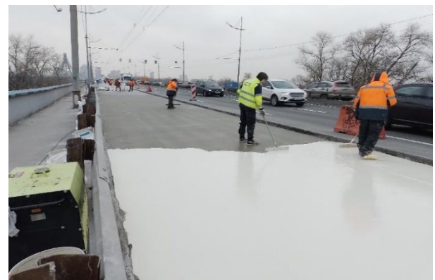
Рис. 3. Влаштування гідроізоляційних систем на основі метилметакрилатної смоли на мості через р. Десенка, м. Київ
